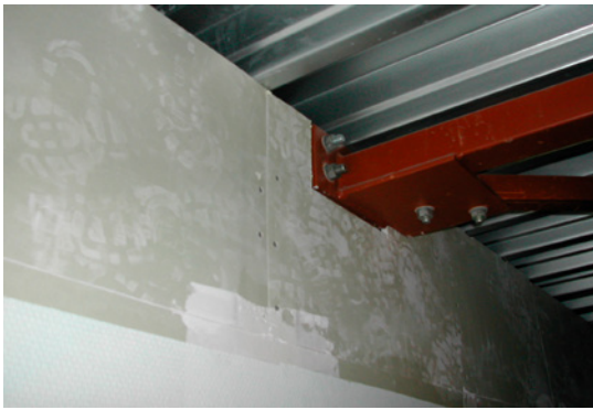
Afb. B.1: Opening tussen dak en brandwerende wand: geen brandwerende scheiding.
