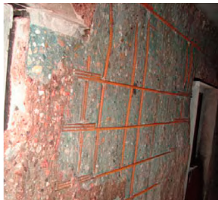
Afb. A.4: Praktijkvoorbeeld van beton dat van de wapening is afgespat.
