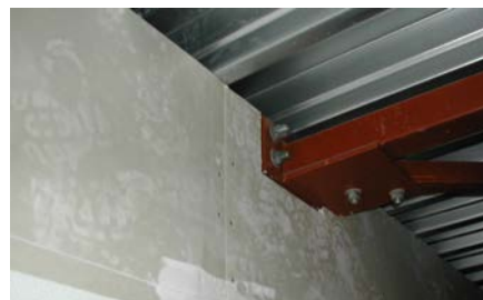
Figuur 25: Opening tussen dak en brandwerende wand: geen brandwerende scheiding
